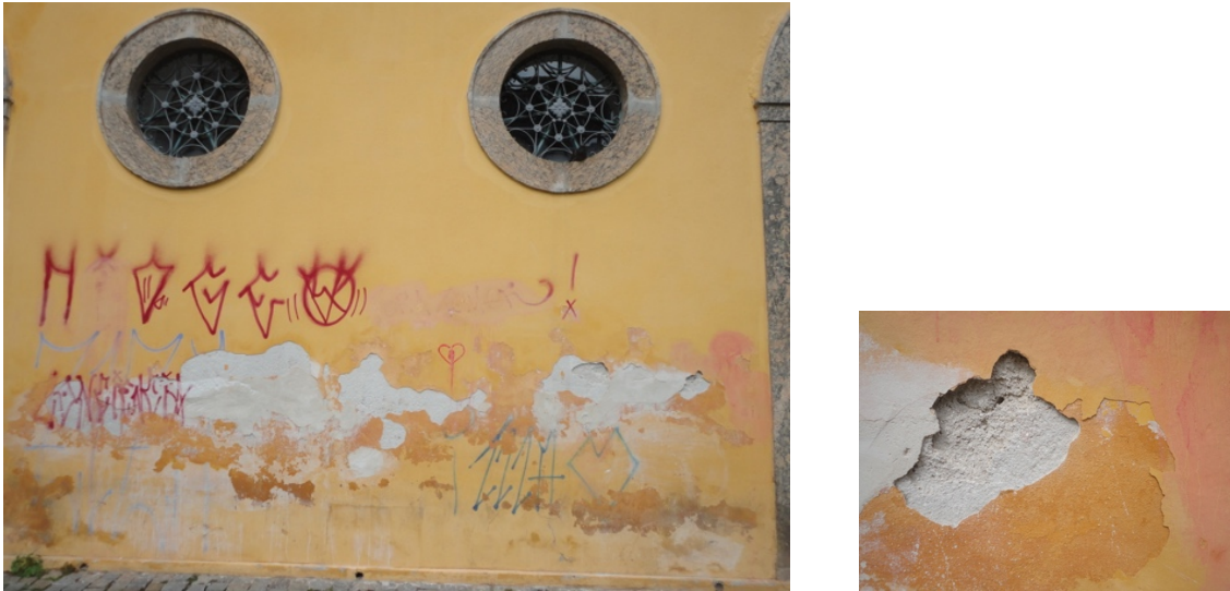
Fig.67 e 68: Fachada da Antiga Alfândega. Paredes do patrimônio sem manutenção.
