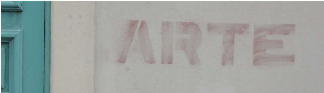
Fig.96: Inscrição apagada ao lado da porta no TAC. Detalhe.
